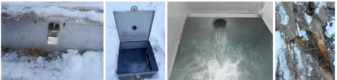
Quellsammelschacht 1 hintere Blaubachquelle: Wasserkammer, Zutrittssicherung, Froschklappe am Ende der Überlauf- Restentleerungsleitung Lokalaugenschein am 08.11.2023
