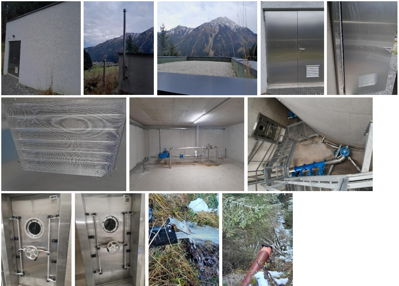
Hochbehälter: Zutrittsstüre Gummidichtung, Be- Entlüftungsöffnungen, Wasserkammern, Funktionsfähige Froschmaulkappen am Ende der Überlauf- und der Restentleerungsleitung Lokalausweis am 08.11.2023
