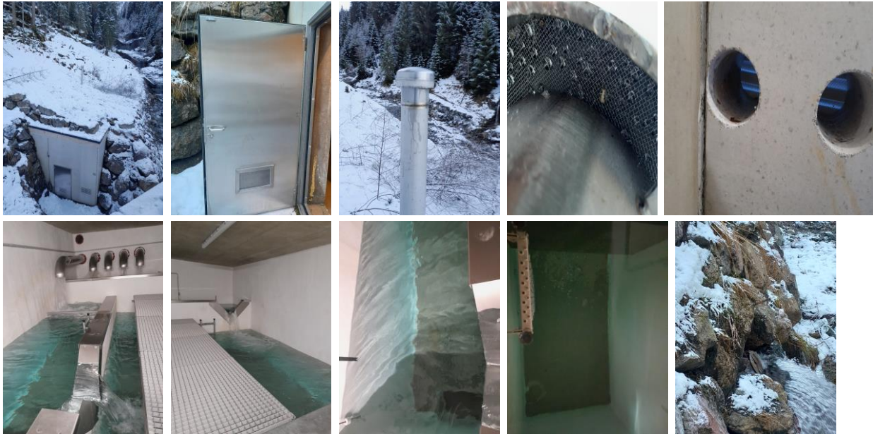
Quellsammelschacht 2: Zutrittsstüre Gummidichtung, Be- Entlüftungsöffnungen, Wasserkammern (Zulauf 1 links: hintere Blaubachquelle; Zulauf 2-5 rechts: vordere Blaubachquellen, Froschklappe Lokalausgutschein am 08.11.2023
